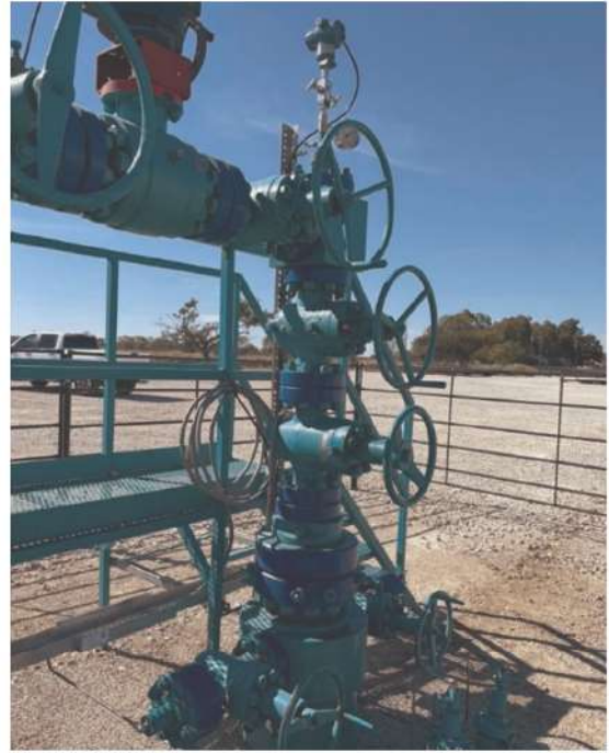
รูปที่ 4.7 ลักษณะของหัวหลุมอัดฉีด CO 2 ของโครงการกักเก็บคาร์บอน ของเครือบริษัท BKV Corporation ณ เมืองแดลลัส รัฐเท็กซัส สหรัฐอเมริกา
